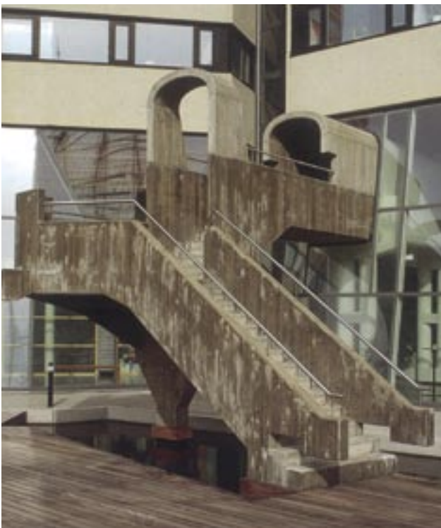
Farbiger Beton mit farbiger Ausblühung.
