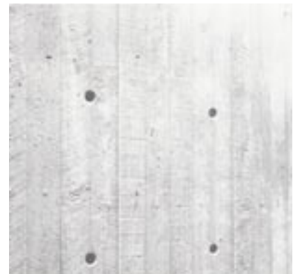
Durch raue Schalbretter entstandene Betonoberfläche
